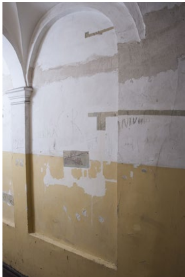
Nisza wschodnia. Zdjęcie przed konserwacją i restauracją. (fot. Iwona Janczewska)
